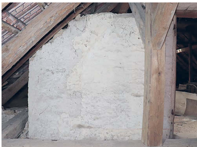
Obr. 13: Fara, podkroví, zděná příčka severního dílu s otisky zaniklé dřevěné klenby a malovaným soklem, pohled od severu, stav 2023.
