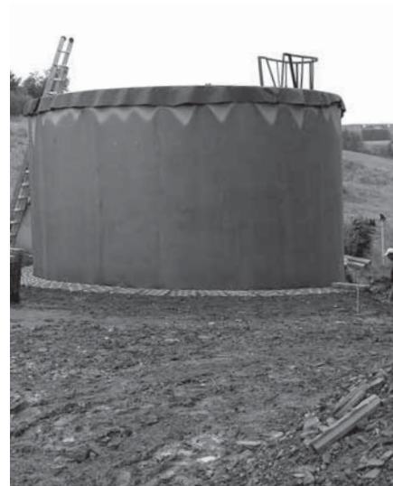
Na vodojemu jsou již instalovány veškeré technologie, dokončují se jen terénní úpravy v jeho okolí
